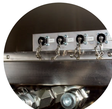
Connessioni per controllo valvole
